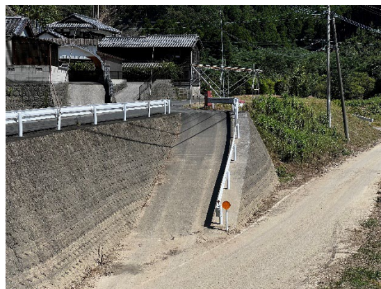
図 3-9 2024 年 8 月出水時の家田霞堤内の 浸水痕跡
