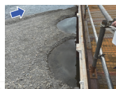
局所洗掘 橋脚近辺が対象
