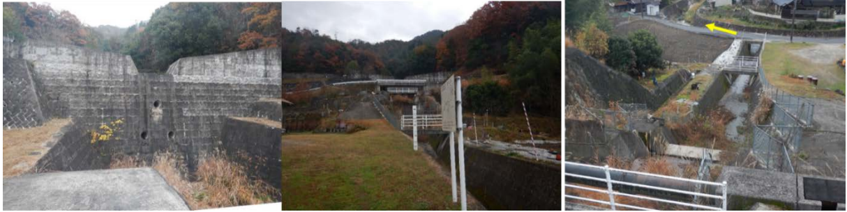
写真 2.1 宝木迫谷川の砂防堰堤（左：下流から望む、中央：下流の流路から望む、右：上流から望む）
