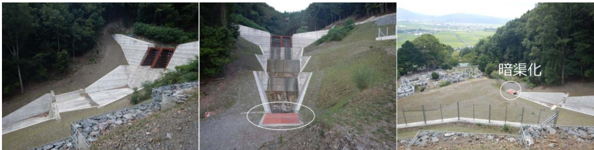
写真 2.2 中谷川の砂防堰堤（左：概観、中央：下流の流路から望む、右：上流から望む）
