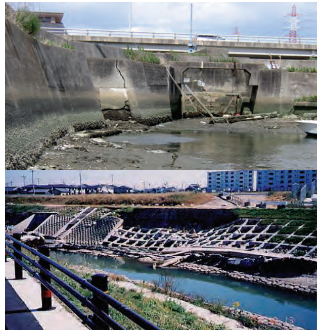
写真6・1 構造物の老朽化や河道特性の変化による護岸工の損壊例
