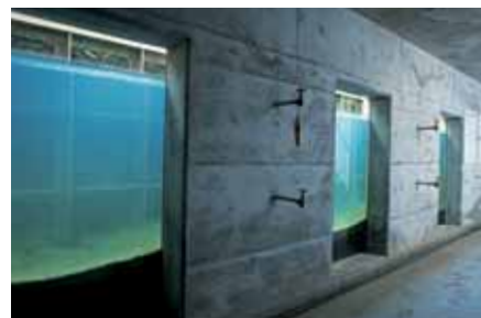
写真⑨ 多摩川の支流、平瀬川の礫間接触酸化(れきかんせつしよくさんか)浄化施設。川のなかの石(礫)の間を水が流れていくうちに、汚濁物質(川の水の汚れの原因になる物質)は川の底にたまって(沈殿)、石にくっついたり(吸着)、微生物のエサになったりして取りのぞかれ、水はきれいになる。この作用を応用して、たくさんの礫をつめた浄化槽のなかに川の水を流して水をきれいにしていく。
