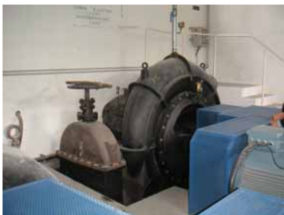
写真 7 揚水ポンプ（1893年蒸気式 1915年電気式）
